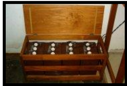
Figura 8.- Baterías que alimentan los equipos EHAS.
